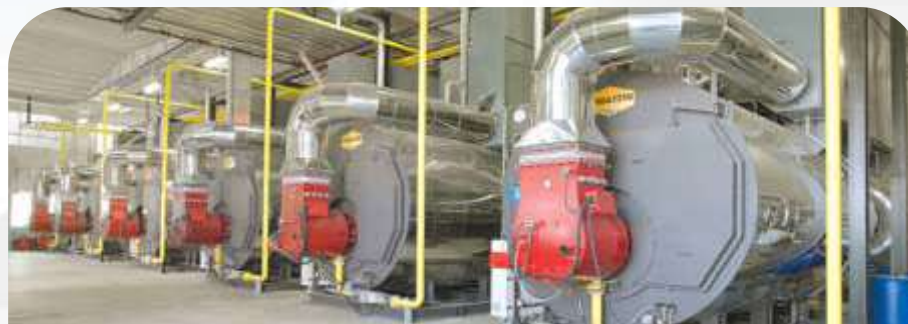
SALA DE CALDERAS
