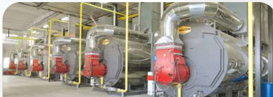
SALA DE CALDERAS
